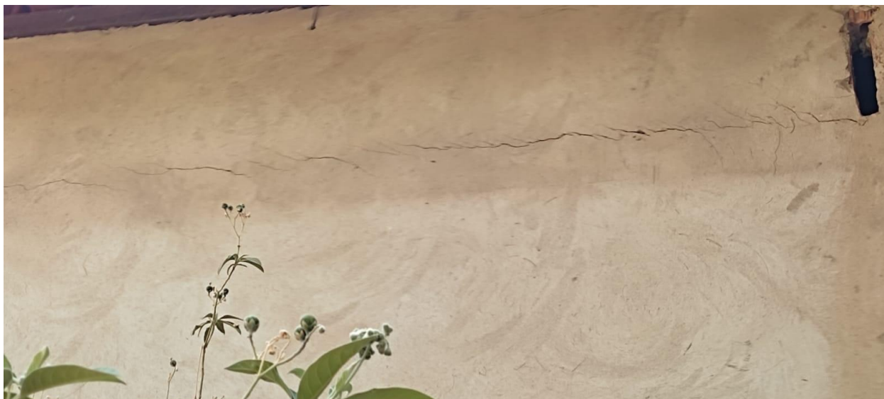
Figura 5: Fissuras na parte do reboco com a viga superior. Fonte: Elaboração própria.
