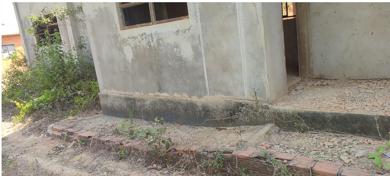
Figura 12: Piso em estado de deterioração acentuada na parte dos fundos. Fonte: Elaboração própria.
