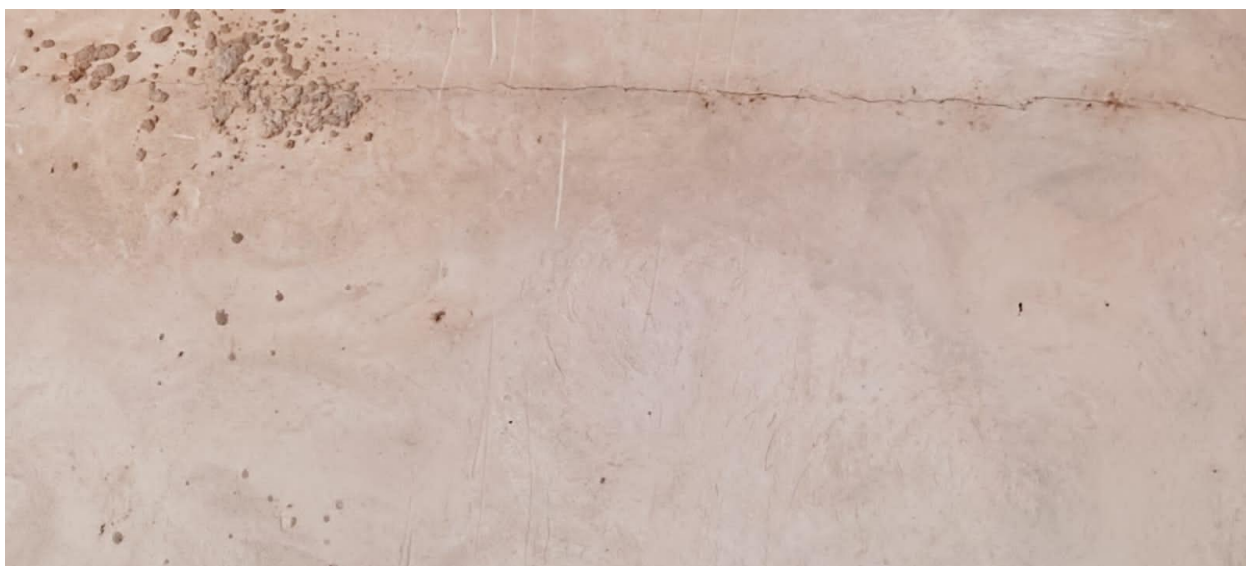
Figura 10: Fissura na parede. Fonte: Elaboração própria.
