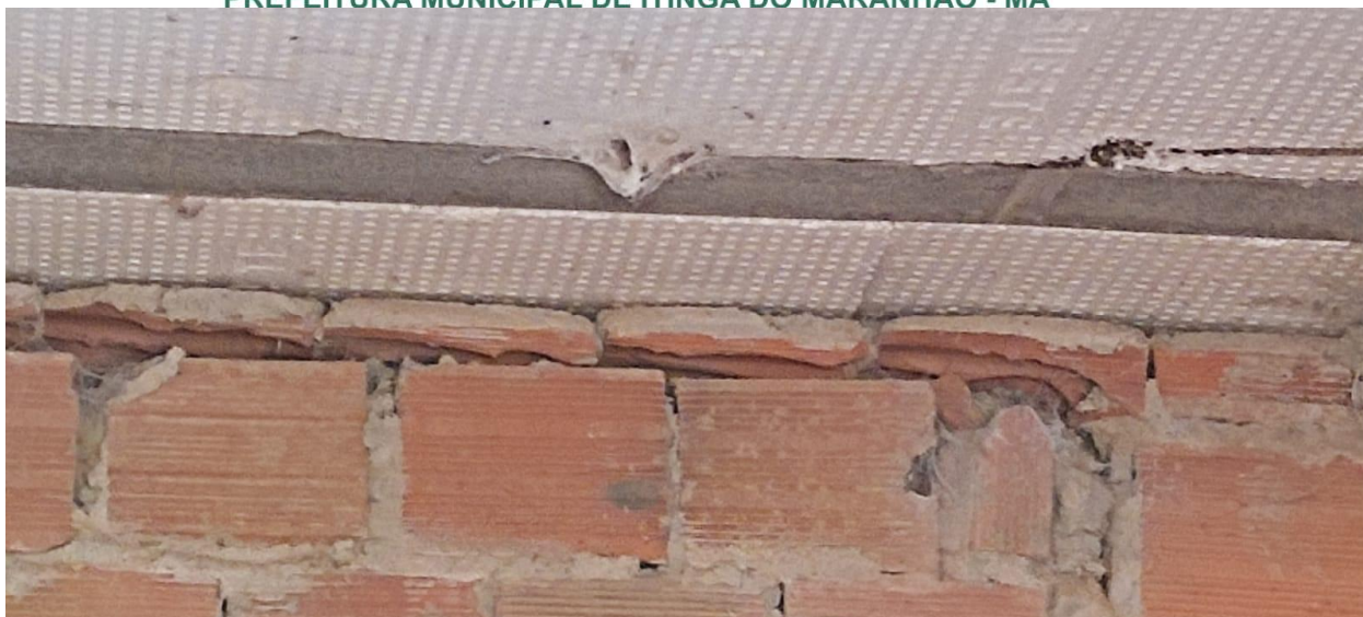
Figura 15: Falta de reboco chapisco sanitários. Fonte: Elaboração própria.
