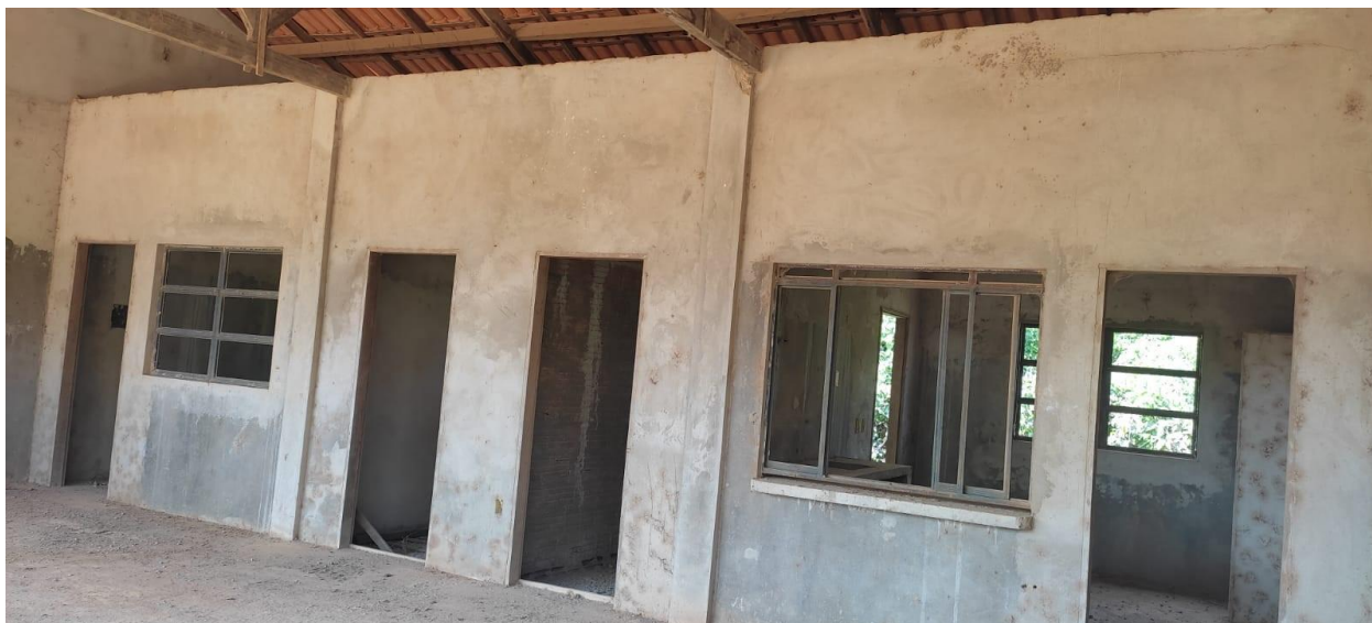
Figura 11: Esquadrias sem vidros e com oxidação. Fonte: Elaboração própria.
