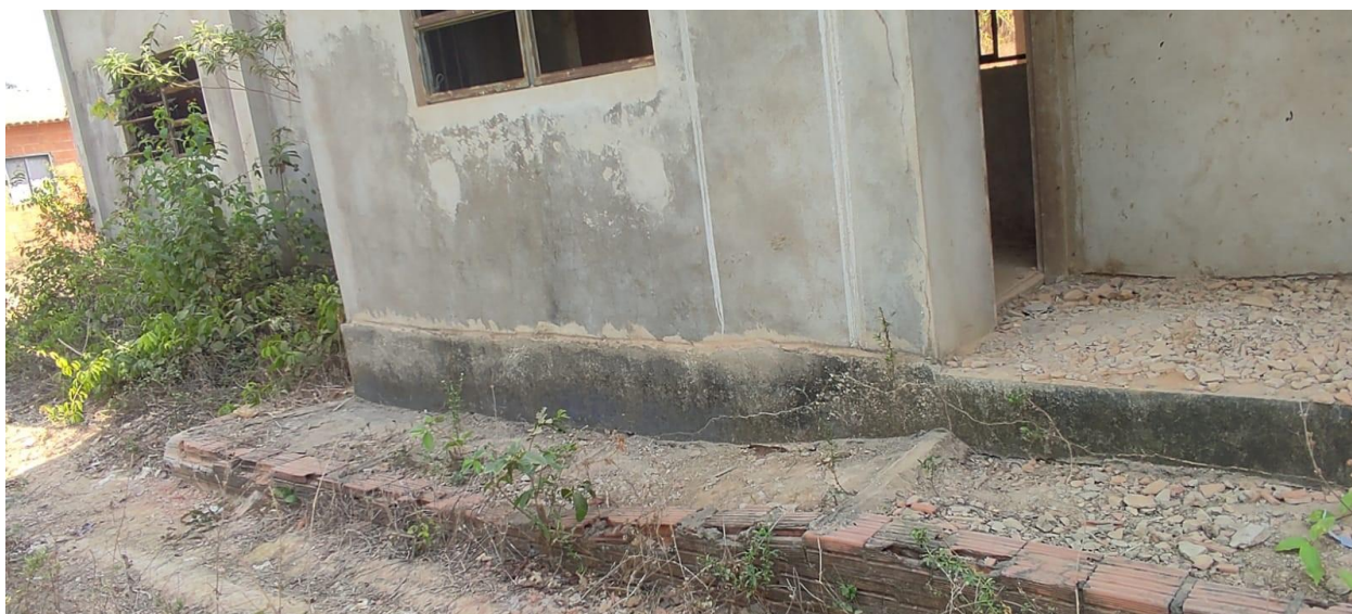
Figura 6: Falta de piso da calçada (atrás da sala administrativa). Fonte: Elaboração própria.
