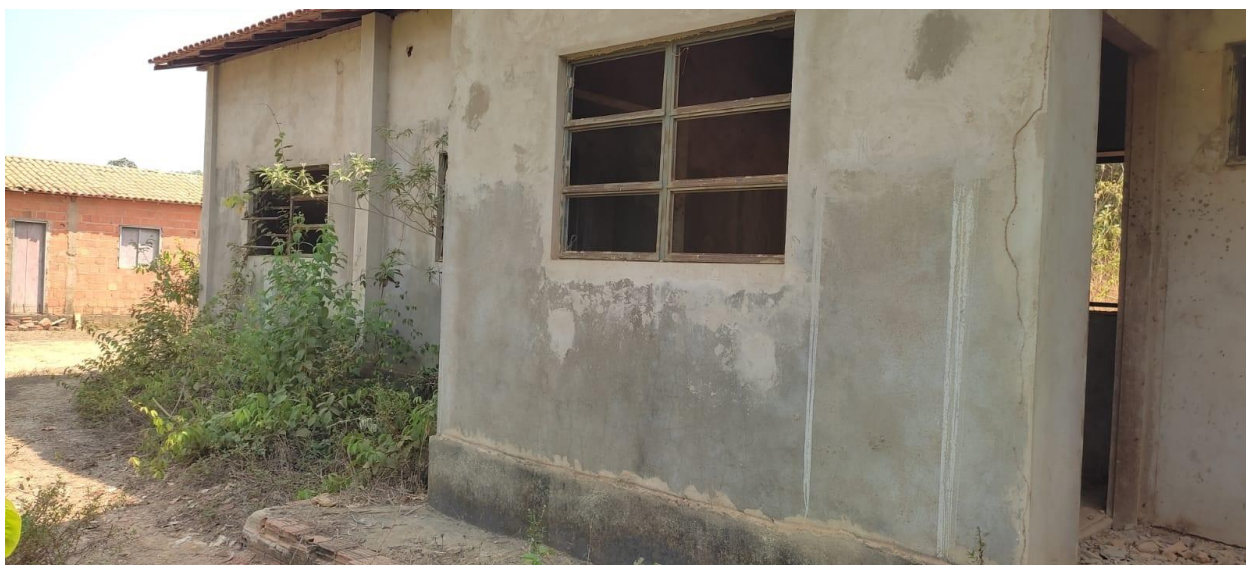
Figura 7: Oxidação da ferragem nas janelas. Fonte: Elaboração própria.
