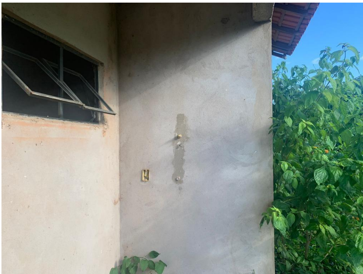
Figura 4: Bloco administrativo janelas sem vidros. Fonte: Elaboração própria.
