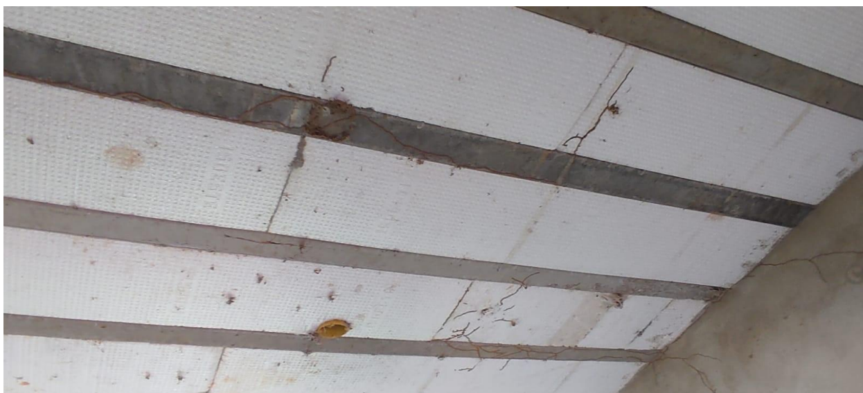
Figura 16: Presença de corrosão, expansão e fissuramento em laje. Armadura exposta e com processo de corrosão iniciado, o que acarretou o surgimento de fissuras.
