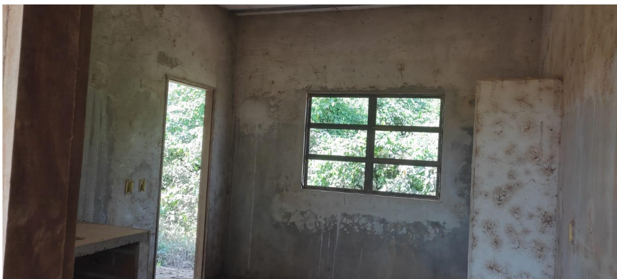
Figura 9: Umidade nas paredes. Fonte: Elaboração própria.
