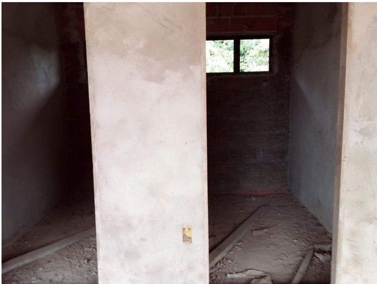
Figura 17: Falta de piso, chapisco, reboco, falta hidrossanitário. Fonte: Elaboração própria.
