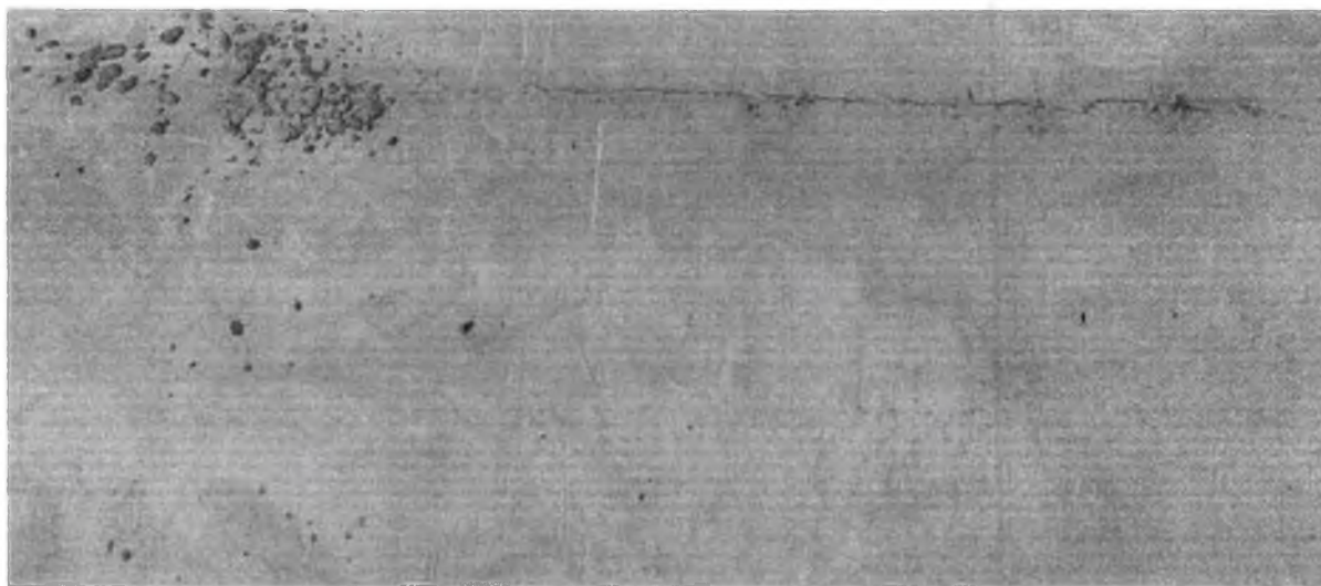
Figura 10: Fissura na parede. Fonte: Elaboração própria.
