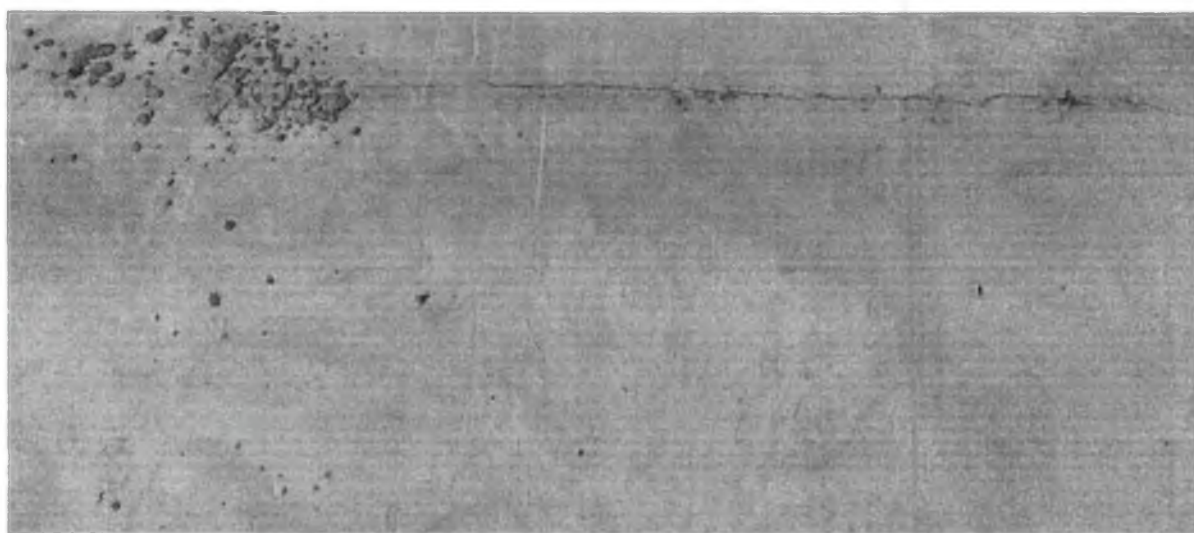
Figura 10: Fissura na parede. Fonte: Elaboração própria.
